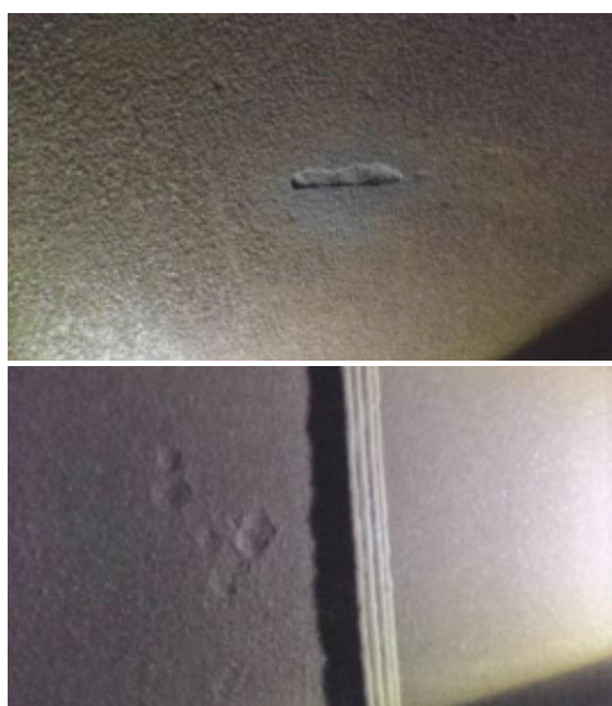
Figura 17 – Fotos da superfície interna, durante a auditoria de IVI, mostram que não há processo corrosivo, mas sim sulcos e mossas causados na fabricação e na montagem, corroborando com o C-Scan executado no INI
