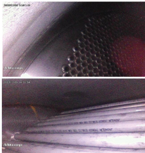
Figura 8 – Registros de inspeção interna por boroscopia
