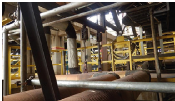
Figura 4 - Tubulações de saída do forno objeto do estudo com parte de sua suportes
