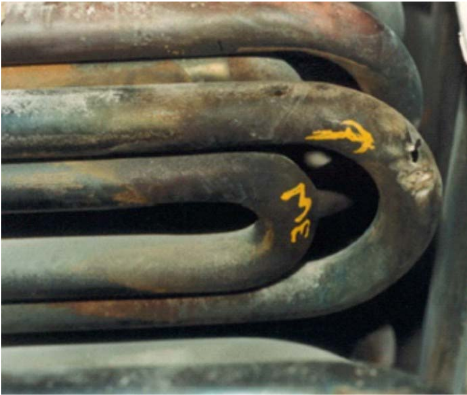
Figura 22 - Perfuração de tubos de caldeira em consequência de processo erosivo resultante de incidência de vapor dos sopradores de fuligem.
