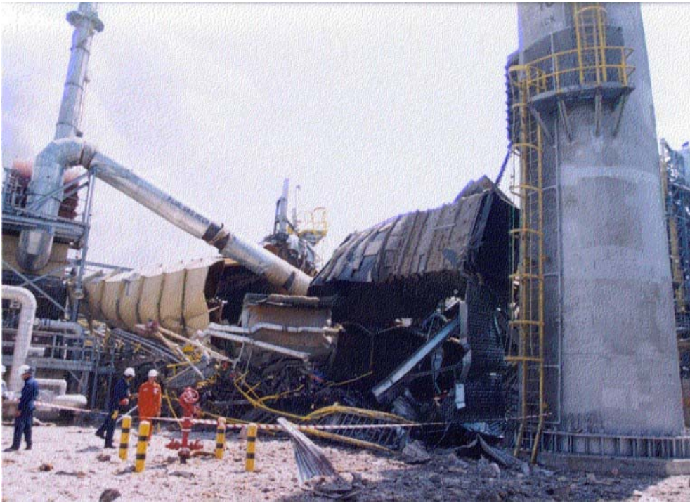
Figura 25 - Exemplo de explosão de câmara de combustão de caldeira.
