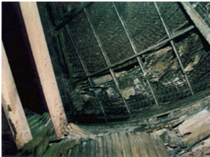
Figura 28 - Deterioração da chaparria de preaquecedor rotativo.
