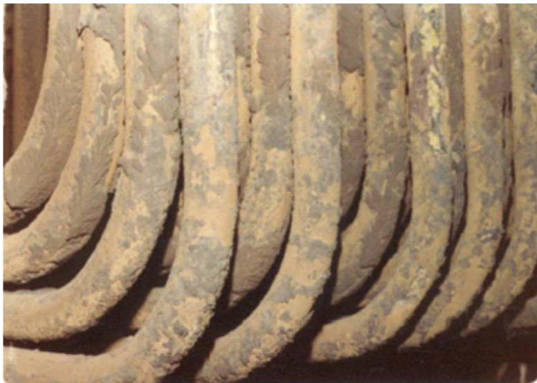
Figura 18 - Serpentina de caldeira exibindo camada de depósitos provenientes de combustão.
