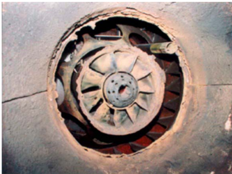
Figura 12 - Queimador de caldeira a óleo exibindo deterioração.
