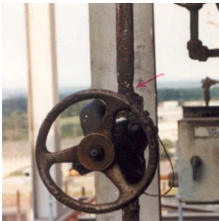
Figura 21 - Detalhe de Corrosão atmosférica sob isolamento térmico na linha de dreno dos coletores de uma caldeira.
