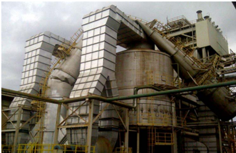
Figura 10 - Colapso de chaminé de caldeira.
