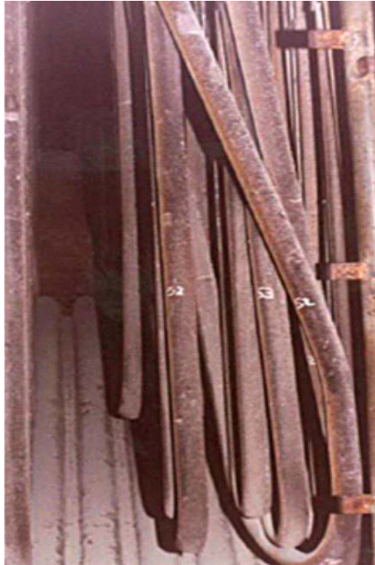
Figura 15 - Serpentina exibindo deformação e flambagem, consequência de sobreaquecimento.
