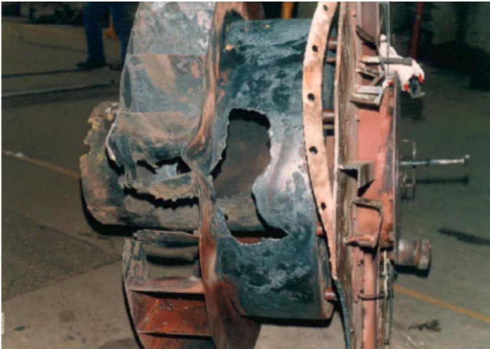
Figura 27 - Deterioração em queimador de óleo.
