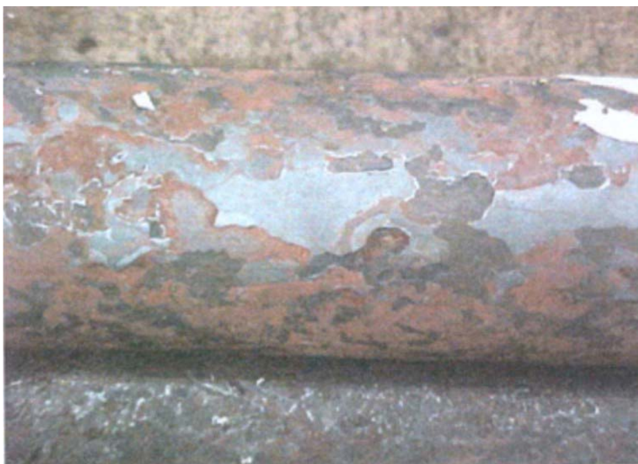
Figura 19 - Tubo de superaquecedor de caldeira exibindo oxidação a alta temperatura.
