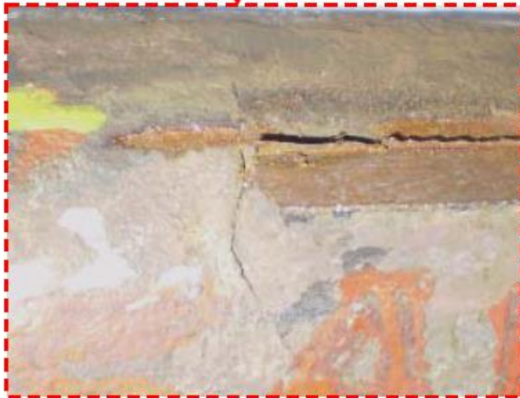
Detalhe da trinca
