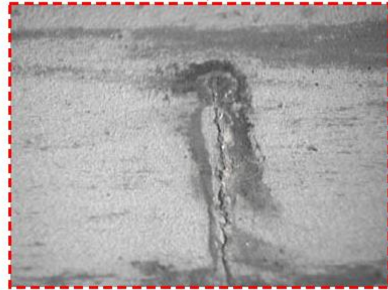
Detalhe da trinca
