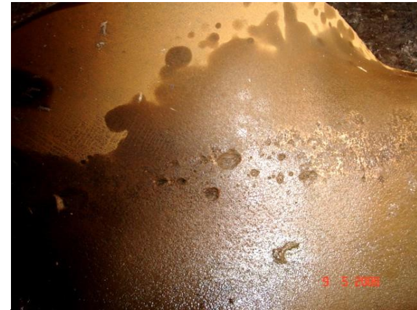
Pites de corrosão (LD)
