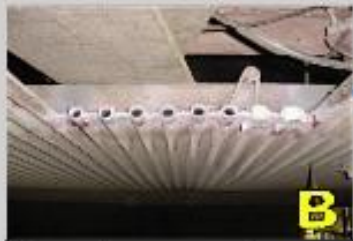
B Teto: trincas nos tubos do evaporador (lado gases) e empenamento excessivo
