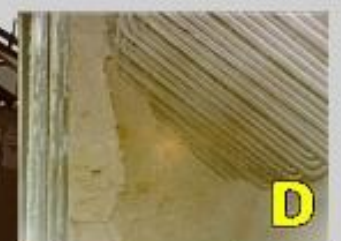
D Aspecto visual do excessivo depósito de cinzas na região próxima a saída da fornalha
