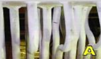
A Trincas nos tubos de interligação teto e coletor superior do soprador
