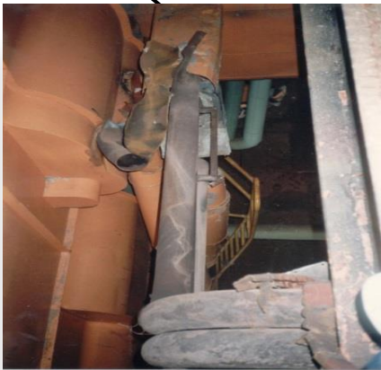
Sobreaquecimento e Corrosão
