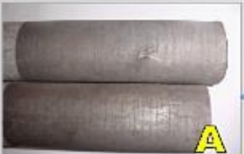
A Trincas nos tubos de sustentação da parede traseira
